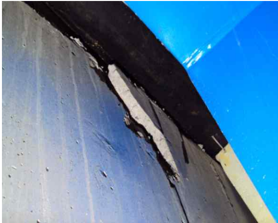
A2 홍벽 파손
